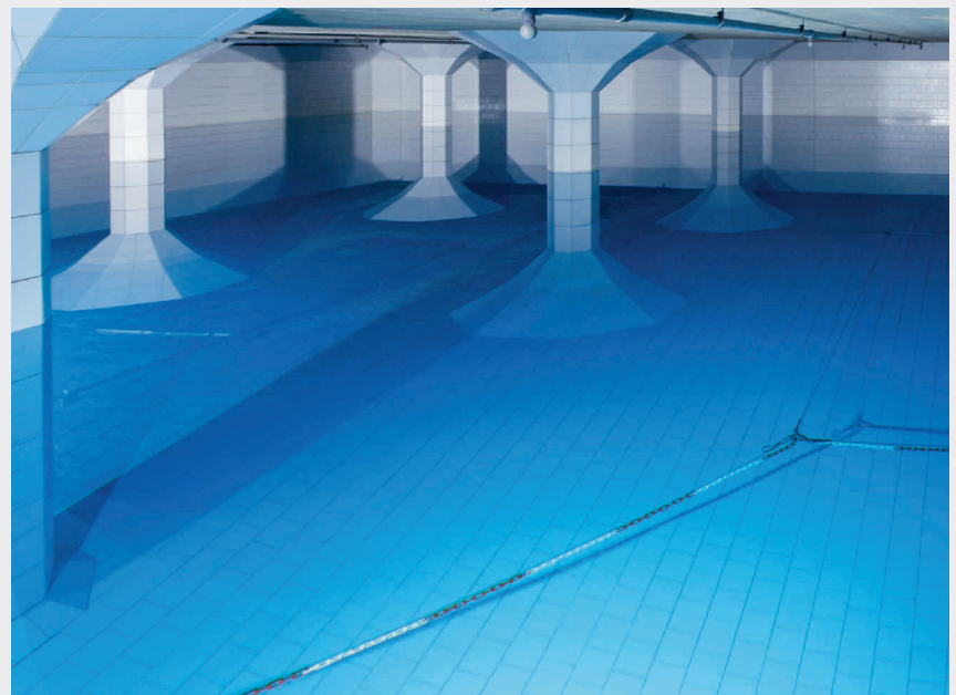
Fig. 9 Das Ziel ist klar: Trinkwasser aus ergiebigen, gut geschützten Vorkommen. Der beste Weg dorthin muss mitunter mühsam ausgehandelt werden (Reservoir Sali Olten).
